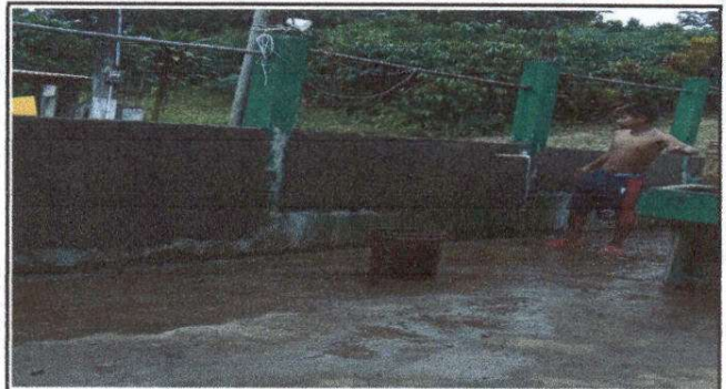
Fotografía 8. Reparación de muro perimetral de block con tubo hg y malla galvanizada, soleras intermedias y columnas.
